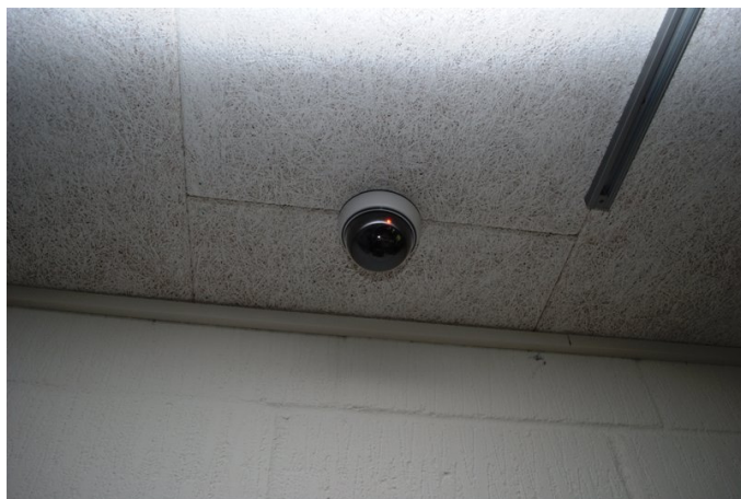
Der er også kommet overvågningskamera op! Er kun aktiveret når klubhuset står tomt! - Læg også mærke til det flotte loft!
